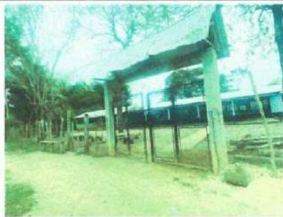
Foto 3: PARTE FRONTAL DE LA CIRCULACIÓN DEL ESTABLECIMIENTO SE REQUIERE SUSTITUCIÓN DE MALLA.
